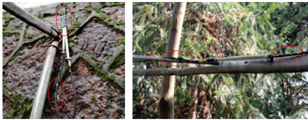
图13: FRP铠装试验光缆试验后示意图
