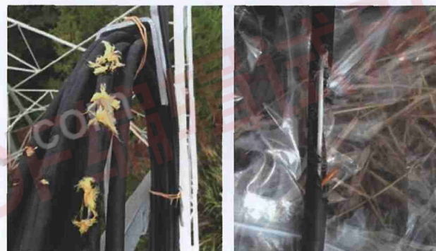
图10(a): 被损坏的光缆 图9(b): 被损坏的光缆
